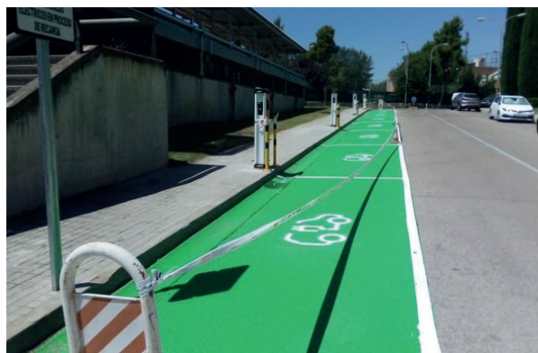
Postes de recarga en la sede de Prado del Rey.
